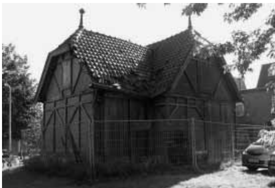
Het storthuisje verkeert al jaren in deplorabele staat.
